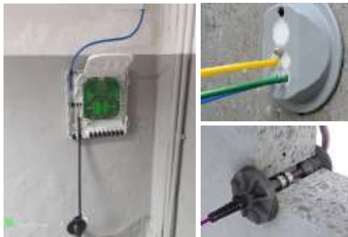
Abbildung 1 Links: Gebäudeeinführung (GE) unten und Abschluss des Glasfaserkabel in der APL-Box zur Kopplung mit der Gebäudeverteilung (blaues Kabel oben). Gebäudeverteilung ist nicht Bestandteil des Anschlusses.
